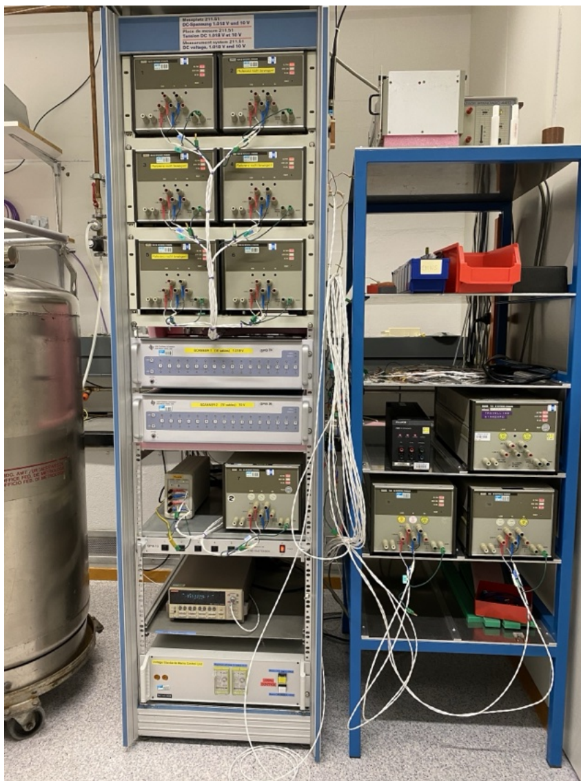
Obr. 13: Pole Zenerových referencií naviazaných na primárny etalón (Josephsonove pole) v METAS, Bern, Švajčiarsko. Foto kredit D. Valúch.
